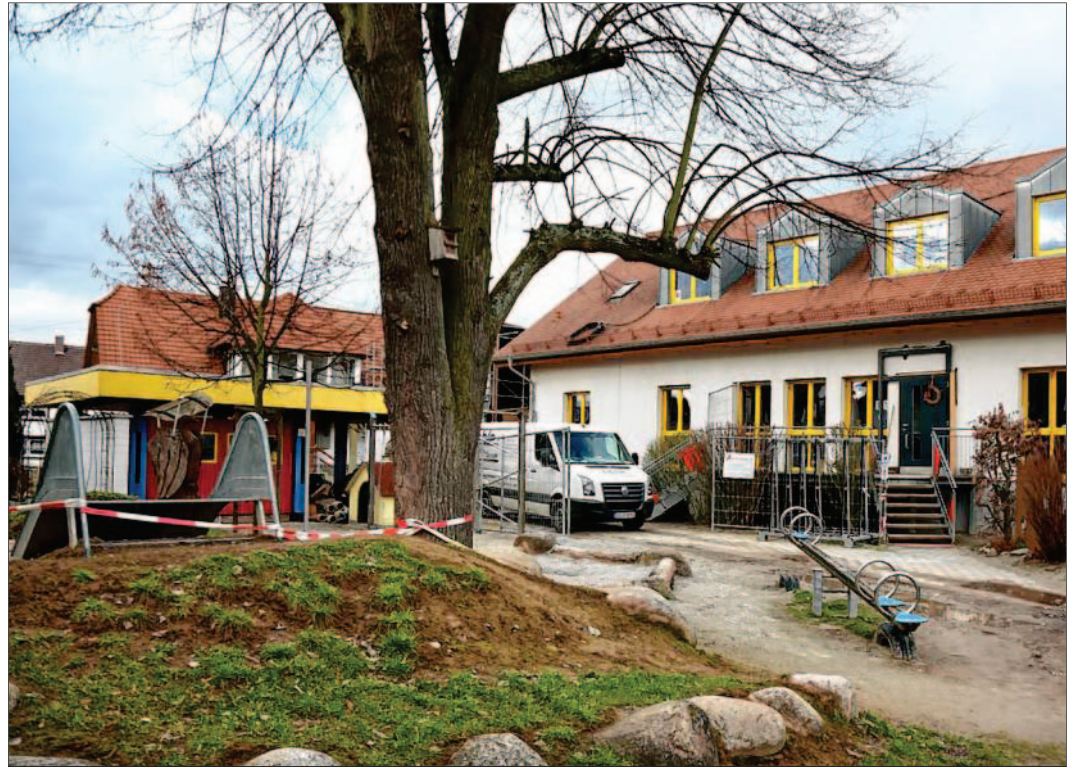
Der Georg-Ehret-Kindergarten in Hofweier weist seit längerer Zeit bauliche Mängel auf. Darauf weisen die Freien Wähler hin.
